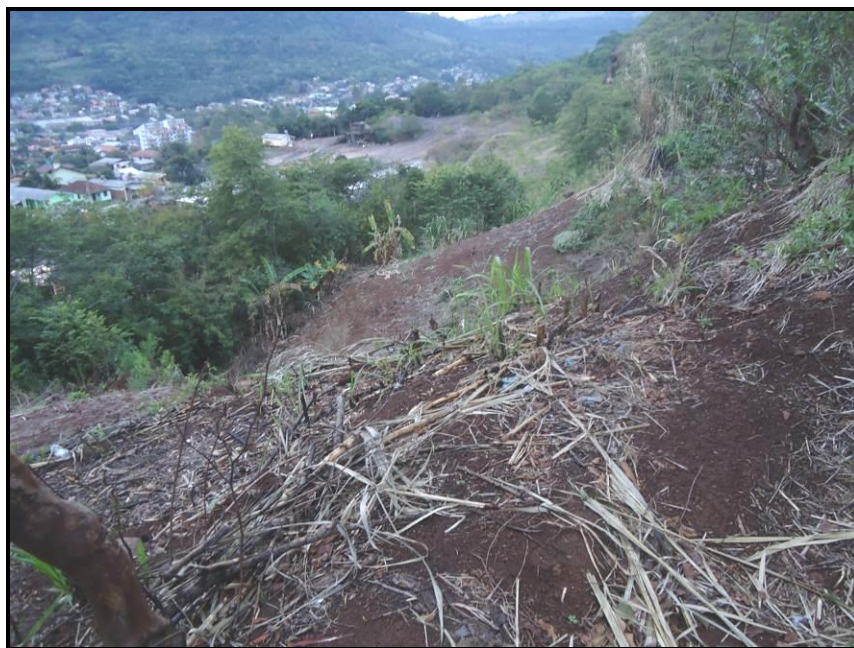
Figura 34. Colúvio na parte superior na área de mineração da Saibreira I (Ponto 22).
