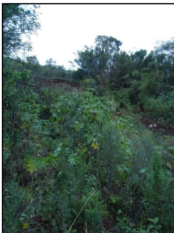
Figura 35. Área que sofreu com movimento de massa atualmente encoberta por vegetação (Ponto 23).
