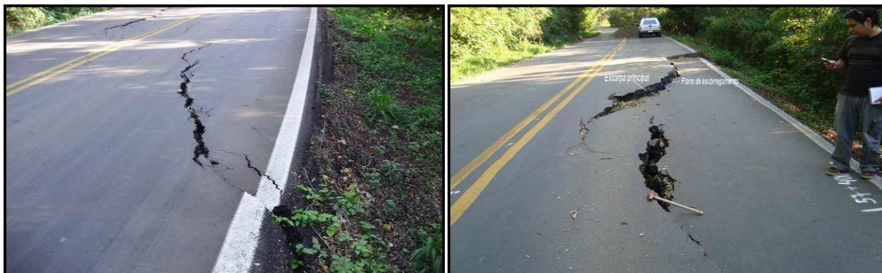
Figura 27. Cabeceira do escorregamento (Ponto 10).
